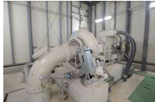
発電所内（水車発電機）
